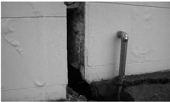
①アシカトレーニングヤード 壁面段差ずれ
