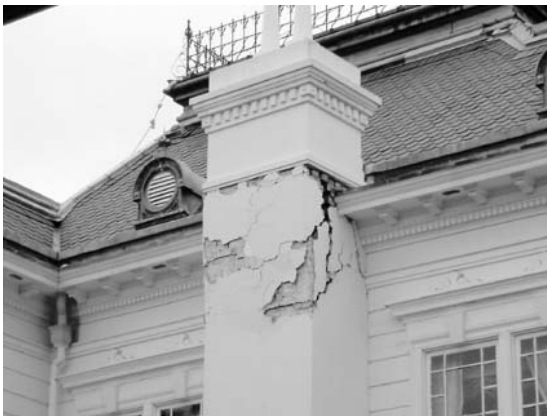
①西洋館 煙突損壊
