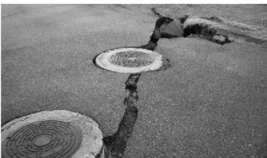
⑦外構通路の地割れ
