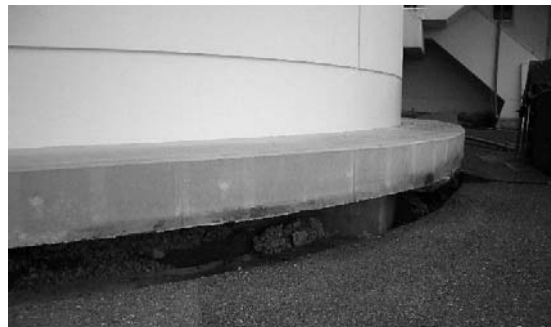
⑥ホスピタルプール 外構の沈下
