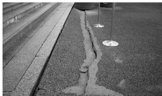
⑧エントランス階段下の地盤沈下
