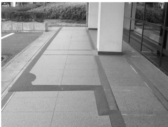
③外周ピロティ部分のずれ(補修後)
