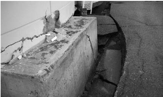
③ホールディングプールB 基礎破断・沈下
