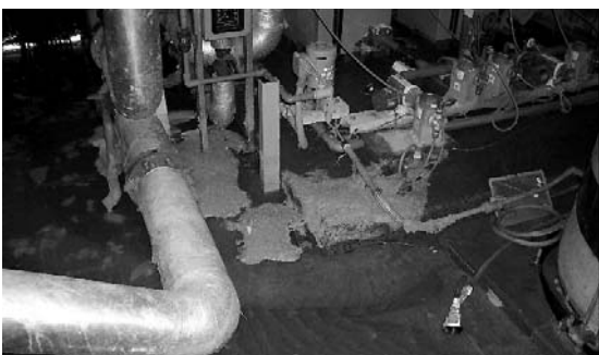
⑨土砂が流入した地下トレンチ
