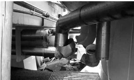
⑤ホスピタルプール 配管破断
