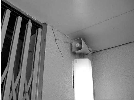
①外壁のひび割れ
