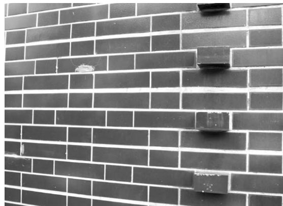
②経年劣化した外壁タイル
