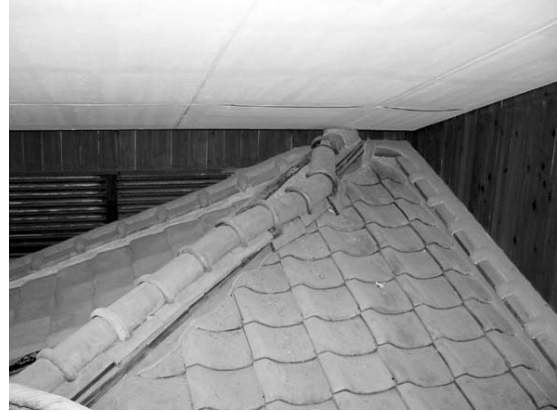
②屋内展示施設の被害
