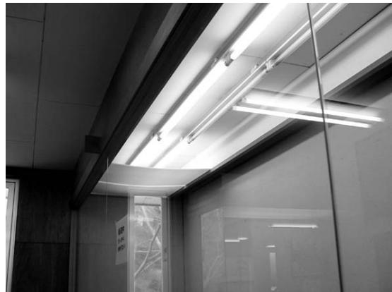
⑫ルーバーが落下した照明器具
