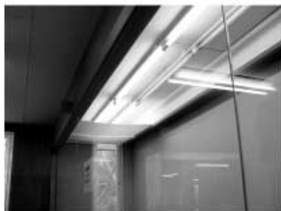
⑫ルーバーが落下した照明器具
