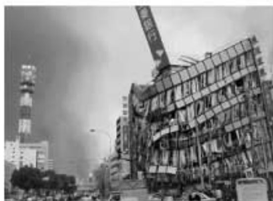
②ビルの倒壊現場
