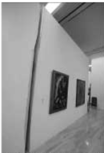
⑦7階アジアギャラリーの仮設壁がずれる
