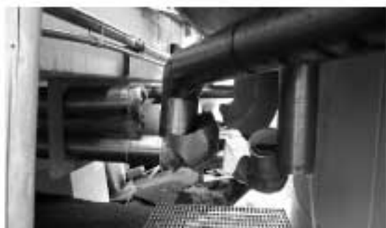
⑤ホスピタルプール 配管破断
