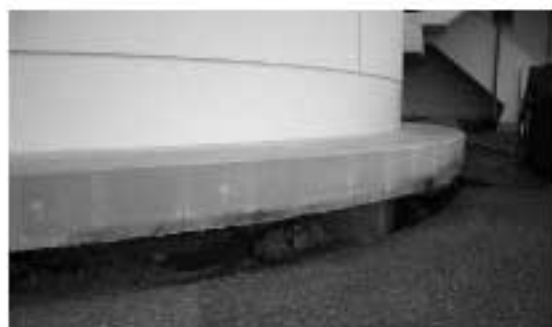
⑥ホスピタルプール 外構の沈下
