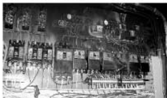
⑩水がかかり焼損した配電盤
