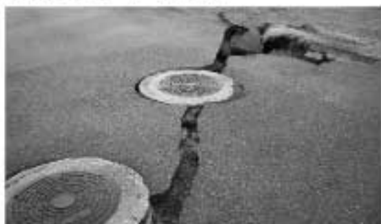
⑦外構通路の地割れ
