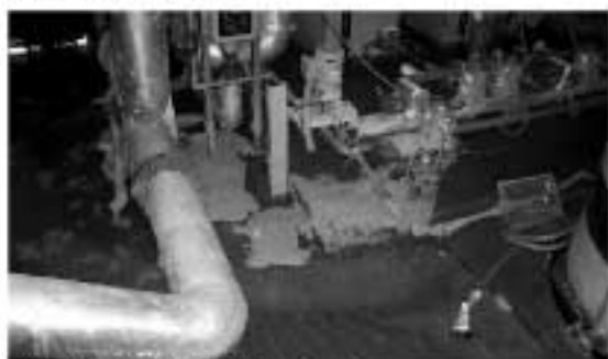
⑨土砂が流入した地下トレンチ
