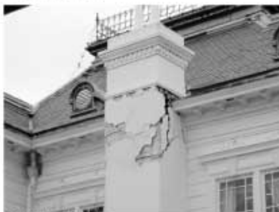
①西洋館 煙突損壊
