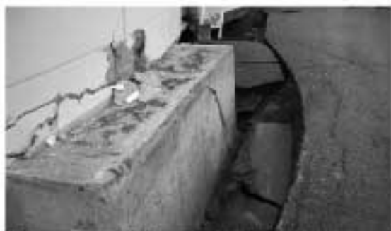
③ホールディングプールB 基礎破断・沈下
