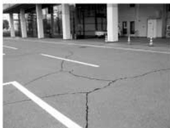
④駐車場の亀裂(補修後)
