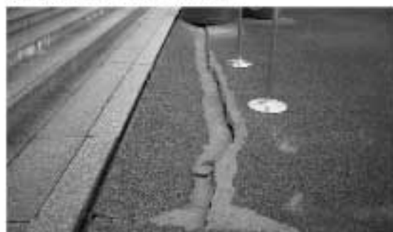
⑧エントランス階段下の地盤沈下
