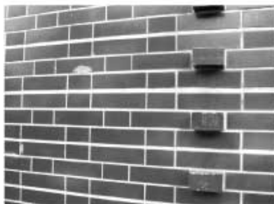
②経年劣化した外壁タイル
